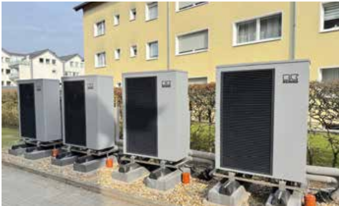
Am Turnplatz 6: Wärmepumpen und Pufferspeicher
